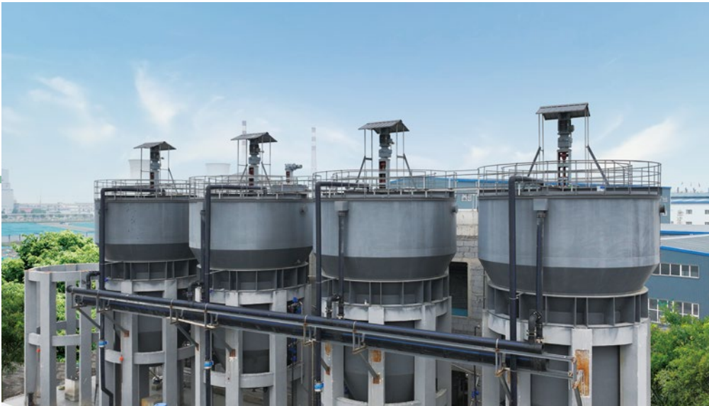
■ 唐山南堡浓盐水达标排放项目 40,000 m 3 /d 浓盐水地表IV达标排放
